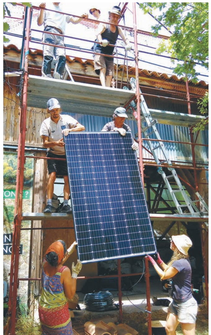
Photovoltaikanlagen erzeugen einen Teil der Elektrizität, die wir für unseren Energiebedarf benötigen. Saatguthangar, Limans.
